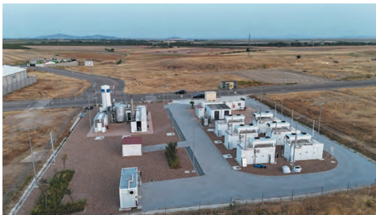
Instalación operativa que produce gas verde en Miajadas (Cáceres)
